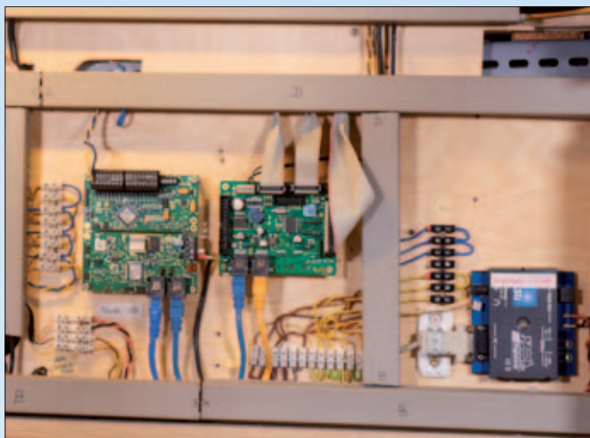
Hinter dem Anlagenrahmen sind die Digitalkomponenten von Fichtelbahn installiert. Patch-Kabel verbinden die Komponenten.
